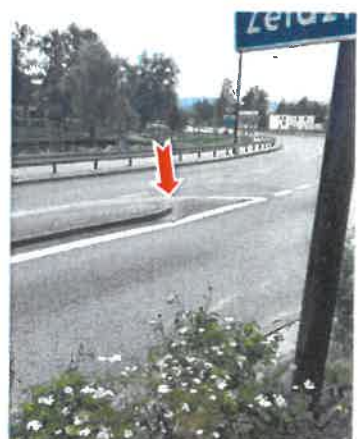
Zapiaszczona studzienka ul. Gdańska, róg Syrokomli
