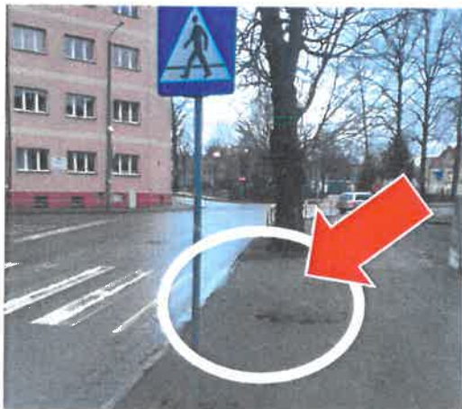
Zapadlisko w chodniku ul. Mostnika
