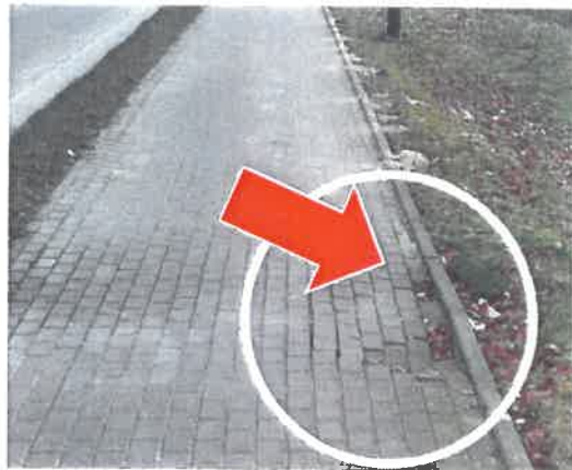
Zapadlisko w chodniku ul. Gdańska (pomiędzy nr 70 a 79)
