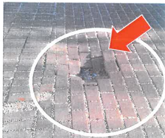
Zapadlisko w chodniku ul. Bieszki (na wysokości garaży w okolicy bloku nr 49 Armii Krajowej)
