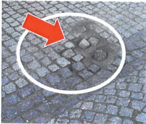
Ubytki w jezdni ul. Korczaka (w okolicy skrzyżowania z ul. Orzeszkowej)
