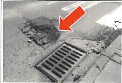
Głęboki ubytek ul. Targowa, przeście przy sklepie rybnym
