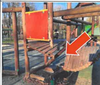
Uszkodzenia na placu zabaw w Parku Michalskiego
