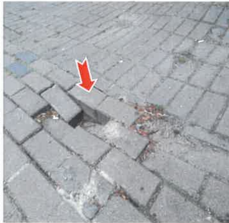
Zapadnięty chodnik ul. Bieszki (przed wylotem na AK 49)
