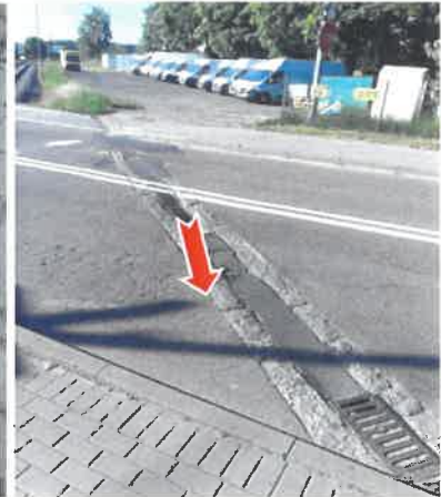
Zdegradowane odwodnienie niszczące opony ul. Kaszubska
