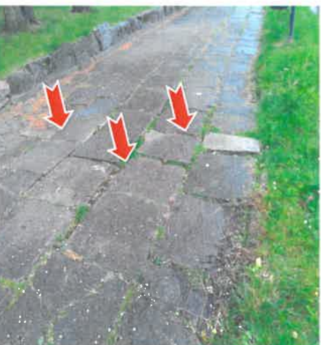
Zdegradowany chodnik pomiędzy stawkiem oraz ul. Przyzamacze
